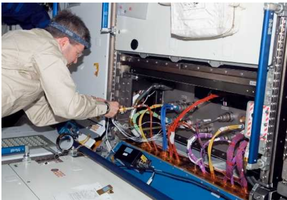
図3.4-6 ハーモニーの電力・通信配線のトラブルシューティング (故障箇所の究明)
